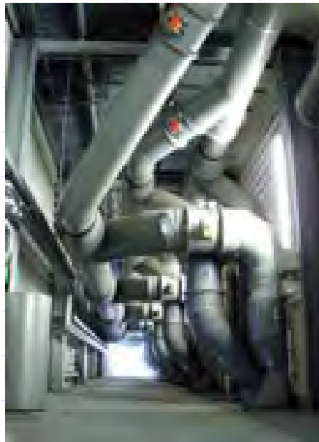
Δίκτυο προσαγωγής αέρα και απομάκρυνσης των VOCs
